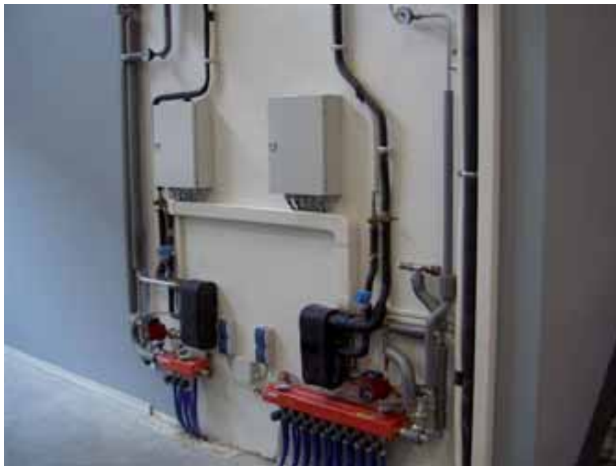
Installatie Lukon Air
