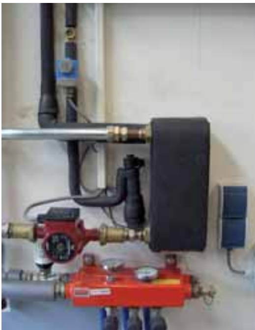
Installatie Lukon Air
