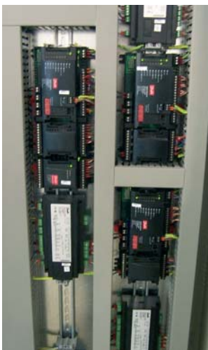
Schakelkast project PS Koeltechniek
