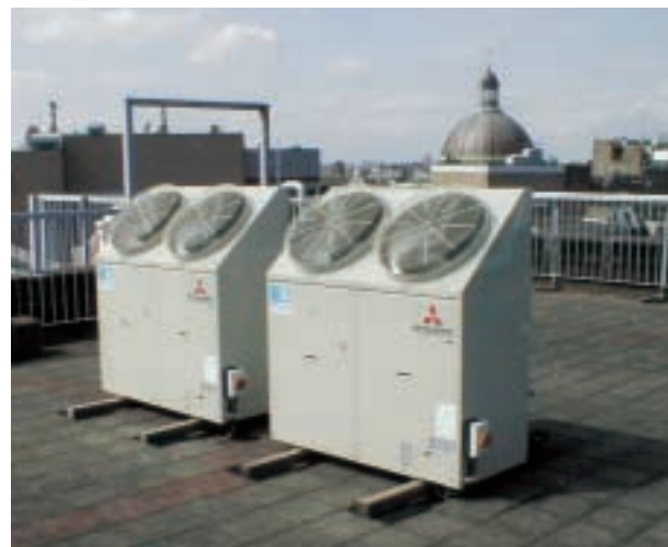
Buitenunit op het dak van Victoria Hotel Amsterdam.
